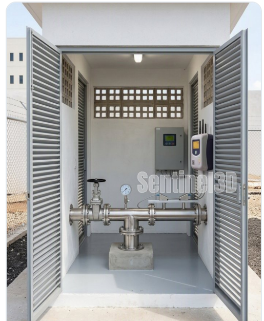
Instalación tipo. Medición, Procesador del Equipo y tablero, dentro de la caseta.
